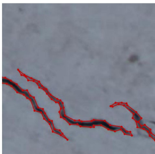
图3 裂缝图像标注过程
