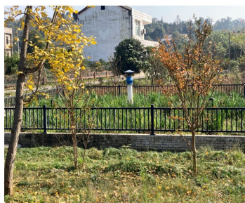
(a) 集中式微动力污水处理站
