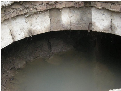
图5 碎石垫层脱落
