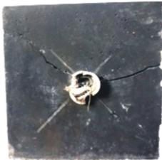
图 2 拔出且劈裂破坏
