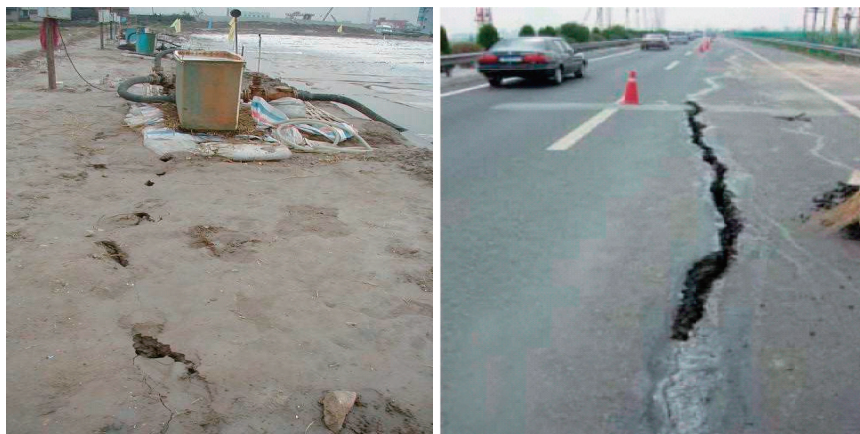
图 1 真空预压引起周边道路破坏
