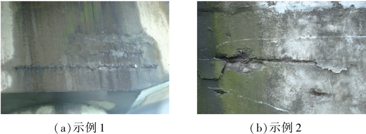
图3 桥梁保护层开裂病害
