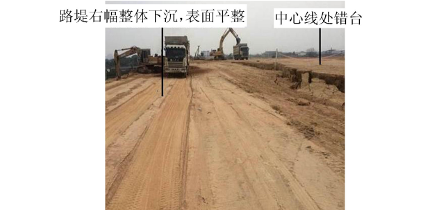
图2 K4+800 ~ K4+900 段右幅路堤整体下沉,表面平整
