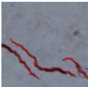
图3 裂缝图像标注过程
