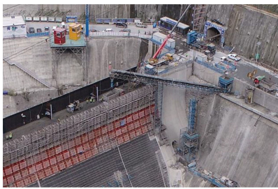
图 4 TB 水电工程偏斜式储料斗与胶带机 水平夹角关系现场应用
