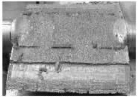
图 5(a) 刘家峡水电站 1 号机组导叶喷涂前磨蚀状况
