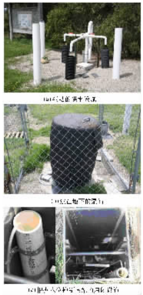
图 5 泵站及其附属设施
