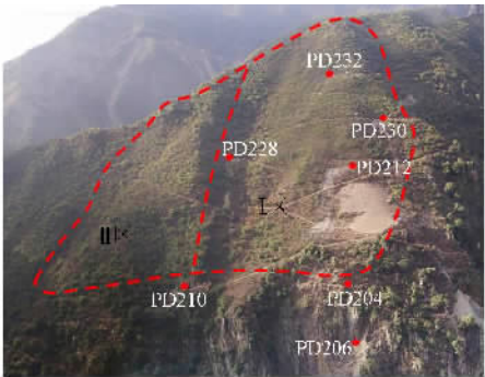
图 1 右岸坝肩高处倾倒变形体
