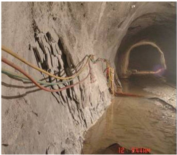
图3 辅助洞东端11号横通道边墙出现的片状破坏 [10]
