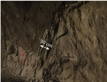
图5 滞后掌子面破裂扩展情况
