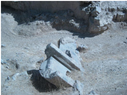
图3 已水毁的放水涵洞洞体断裂
