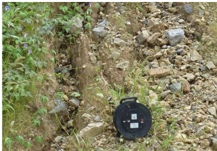
图1 滑坡后缘张裂缝
