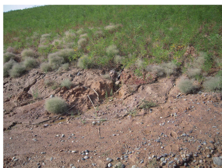
(a) 坝脚局部渗漏点
