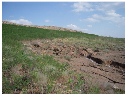
(b) 绕坝渗漏位置
