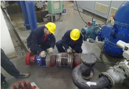
图3 5号机组1号水泵密封环破裂
