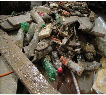
图7 深井泵吸水口堵塞大量杂物
