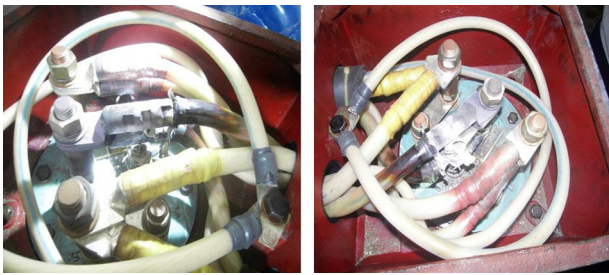
图2 6号机组1号水泵电机电源接头烧毁
