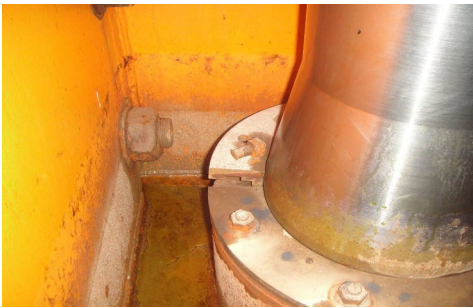
图1 密封压板螺栓断裂
