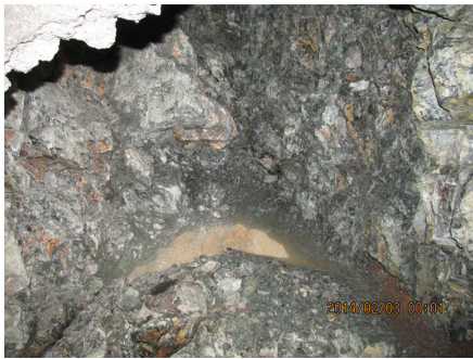
图 7 左旁洞 K16+130.87 m ~ K16+128.67 m 塌方
