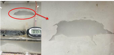
图 12 拱结构空间坍塌上移
