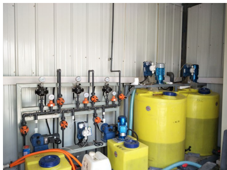
图4 一体化超滤污水处理试验装置加药罐
